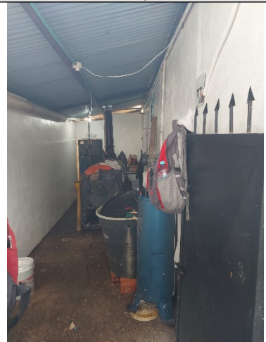
Ingreso a caldera
