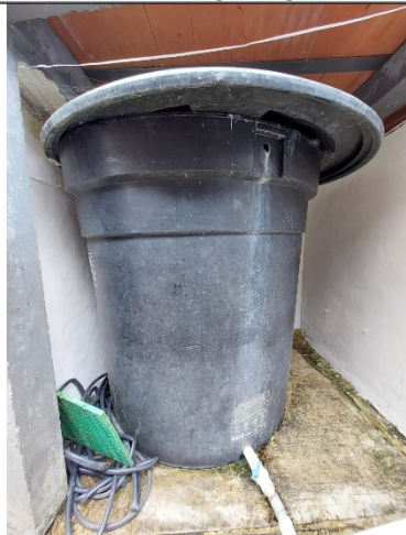
Tanque de almacenamiento de agua
