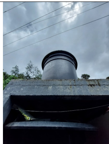
Tanque de almacenamiento
