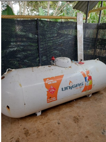
Tanque de gas (combustible)
